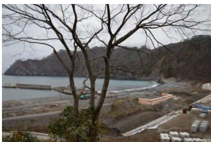
復旧が進みつつある海岸の山側へ→
